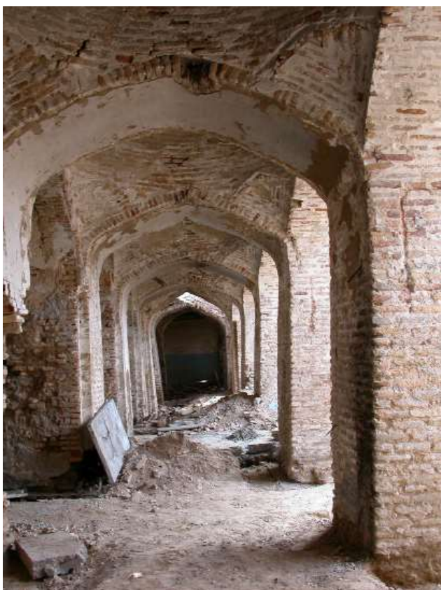
Рис.4. Внутренняя галерея и вид отрубленных колонны Fig. 4. Inner gallery and the view of the broken columns
