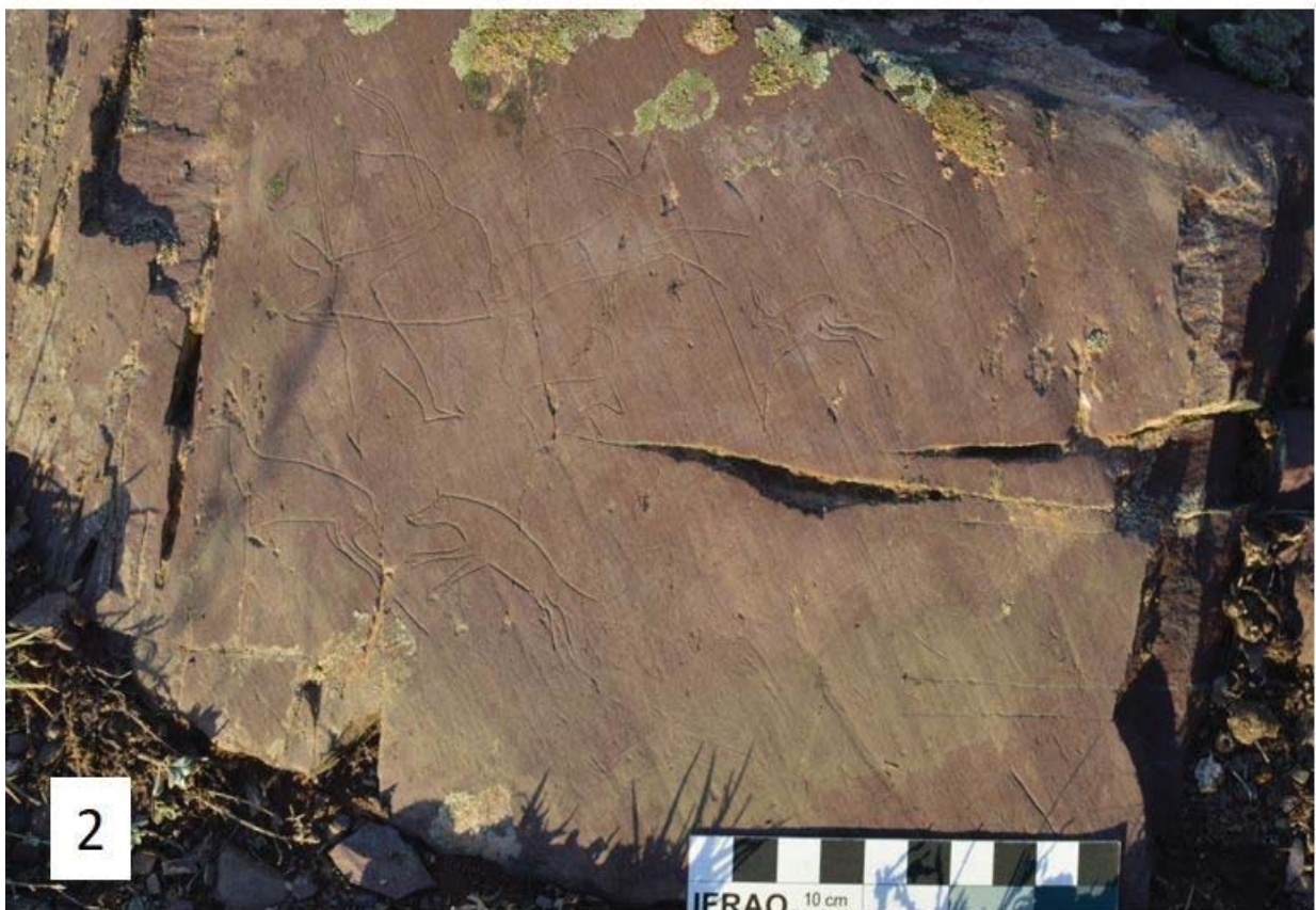
Рис. 5. Крупные трещины, каверны и литофиты на плоскости памятника Дялбак. Fig. 5. Large crack, caverns and lithophytes on the plane of Dyalbak monument.
